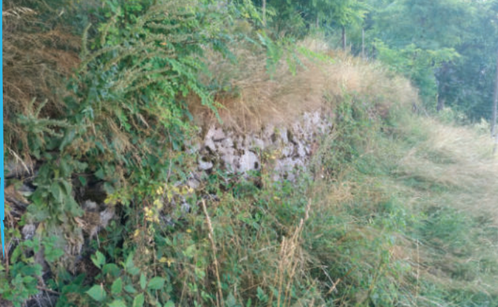
Muret en pierres sèches à restaurer. © Arthur Keller
